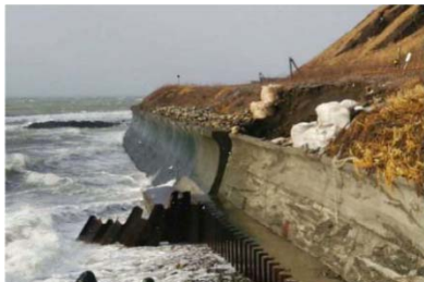
厚賀～大狩部間の盛土流出(1/13プ以資料より)
